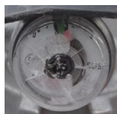
× 指示圧力計の損傷
