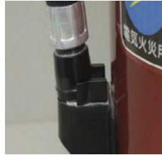
× 消火薬剤の漏れ
